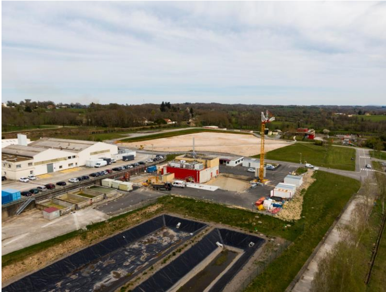
Photo 1 : vue aérienne de l’installation depuis la partie Ouest du site industriel de Bessines [Mai 2019]. Voir localisation cartographique sur l’annexe 4.
